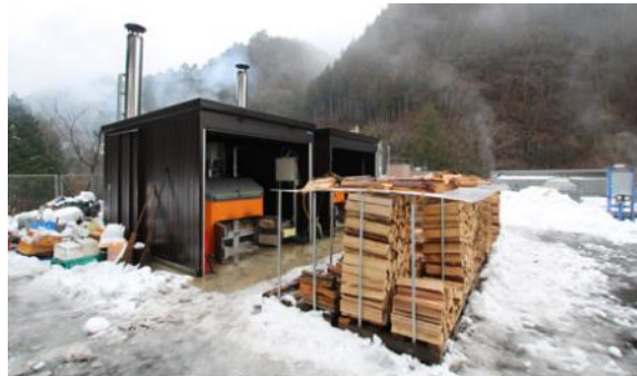
檜原温泉センターの薪ボイラー 56
