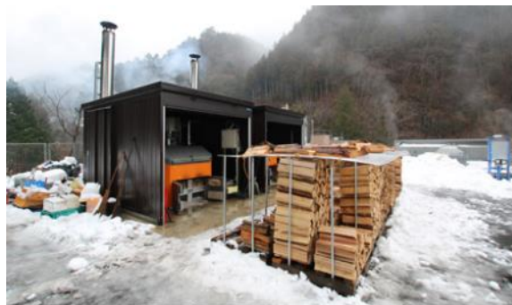
檜原温泉センターの薪ボイラー 56
