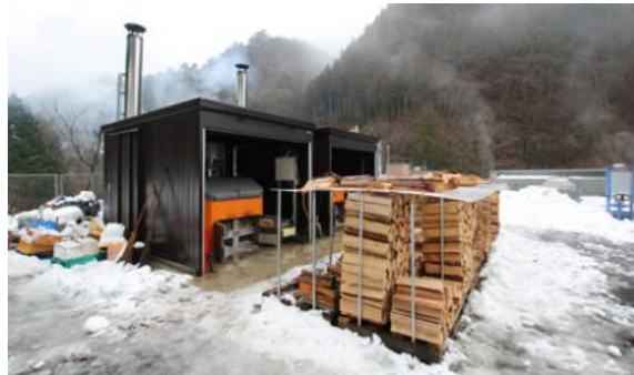
檜原温泉センターの薪ボイラー 55
