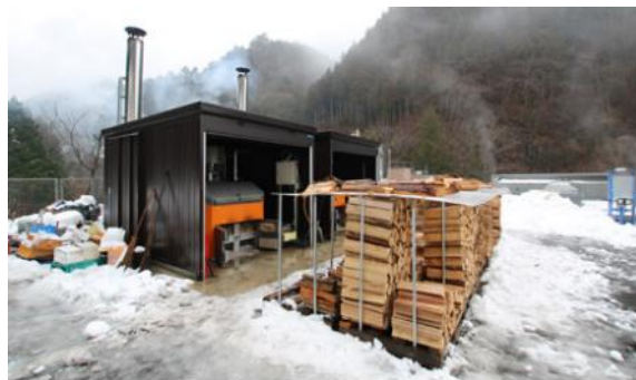
檜原温泉センターの薪ボイラー 39
