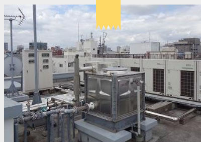
【空調設備 室外機群】
