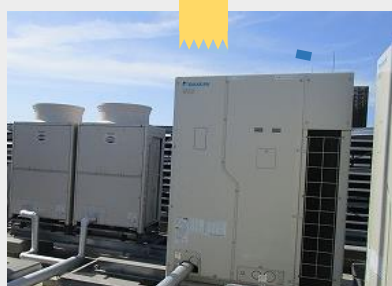
【空調設備 室外機群】
