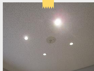
【EVホールLED照明】
