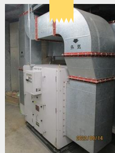
【全熱交換機(各フロア2台)】
