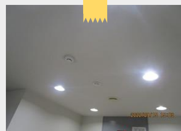
【ダウンライト照明(トイレ)】
