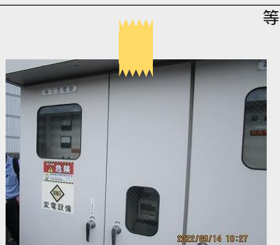
【受電盤の様子】
