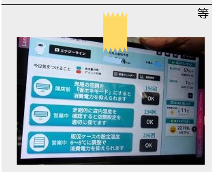
【デマンド監視・エネマネシステム】
