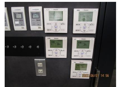
【空調・換気設定管理】
