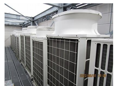
【空調機室外機】
