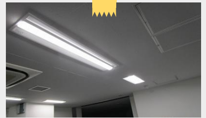
【2階専有部LED照明】
