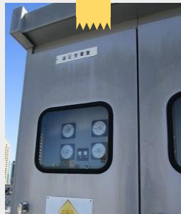
【受変電盤の様子】
