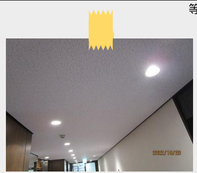
【8階共用部廊下LED照明】
