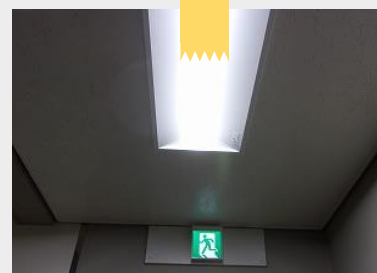
【共用部LED照明とLED誘導灯】
