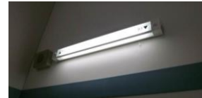
【人感センサー付階段通路誘導灯】
