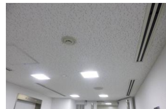
【共用部 LED 照明】
