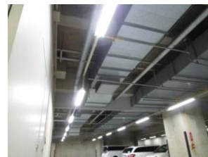
【駐車場 LED 照明】
