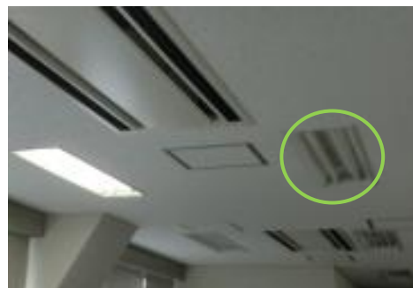
(テナント部分の照明間引き)
