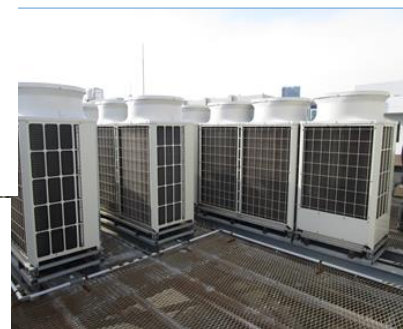
【空調機室外機】
