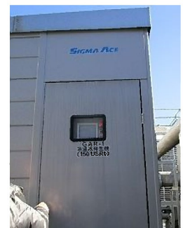
【冷温水発生機】
