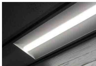
【高効率照明器具の採用】
