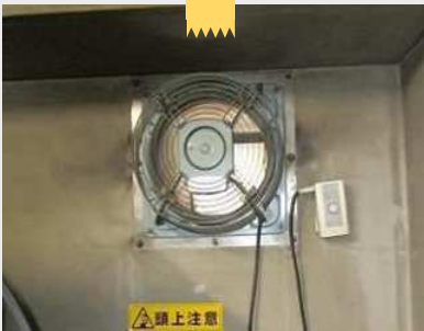
【エレベーター室換気扇（温度制御）】
