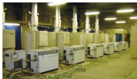
図表2-1-1-24 ガスを利用した発電機
