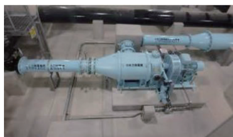
〔小水力発電設備〕
