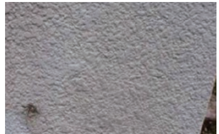
Vật liệu phủ hoàn thiện chứa amiăng (ví dụ tường ngoài)
