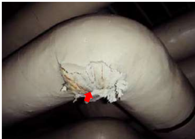
写真 4 石綿含有保温材の使用例（配管エルボ部に使用） 8)
