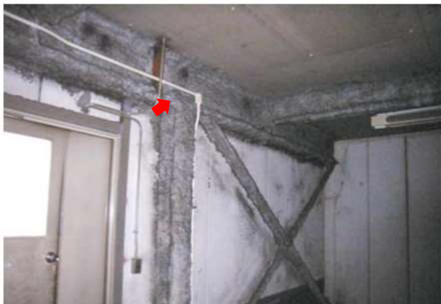
写真2 石綿含有吹付けロックウールの使用例① 8)
