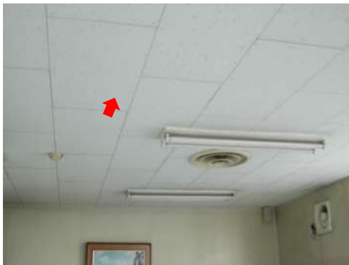
写真8 ロックウール吸音板の使用例（天井に使用） 8)
