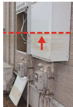
冠水した給湯器
