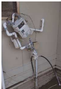
LPガス設備の損傷
