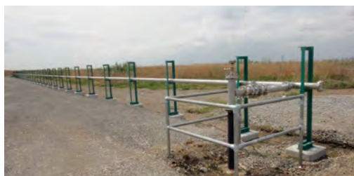
写真8 外側集ガスライン
