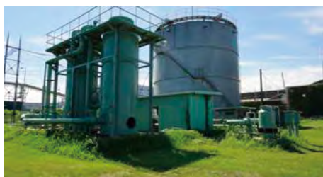
写真5 脱硫器・ガス貯留設備
