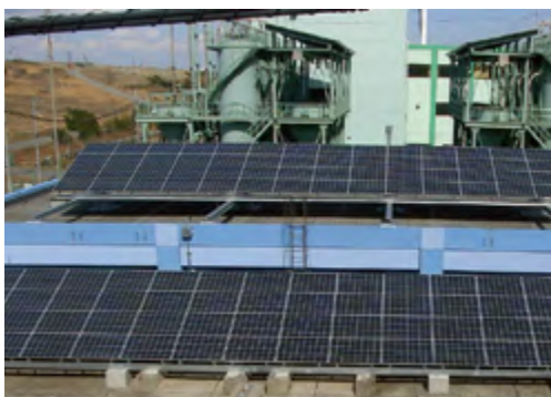
写真16 太陽光発電設備
