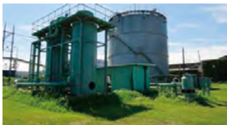
写真5 脱硫器・ガス貯留設備
