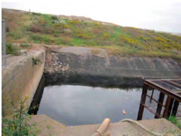
写真1 集水池(ポンプ井)(外側埋立処分場)
