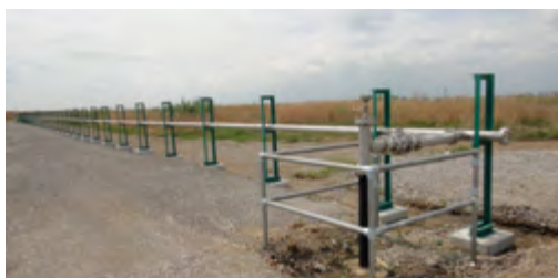
写真8 外側集ガスライン
