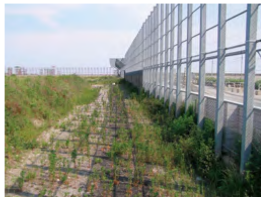
写真10 ごみ飛散防止フェンス
