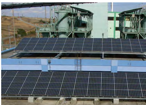
写真16 太陽光発電設備
