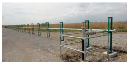
写真8 外側集ガスライン
