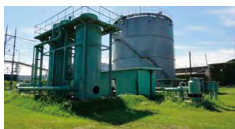
写真5 脱硫器・ガス貯留設備
