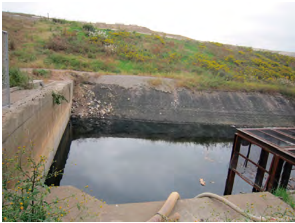
写真1 集水池(ポンプ井)(外側埋立処分場)
