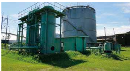
写真5 脱硫器・ガス貯留設備
