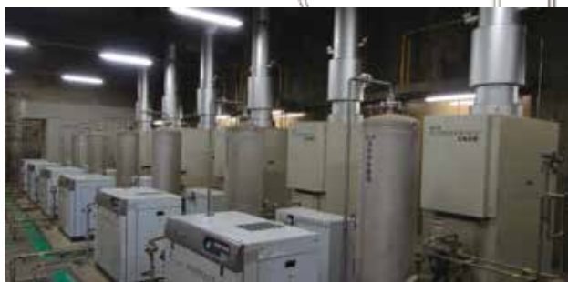
写真7 マイクロガスタービン発電機(発電機棟内部)
