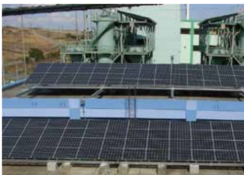
写真16 太陽光発電設備
