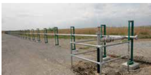
写真8 外側集ガスライン
