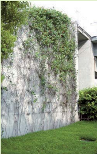
壁面上部に偏った壁面緑化
