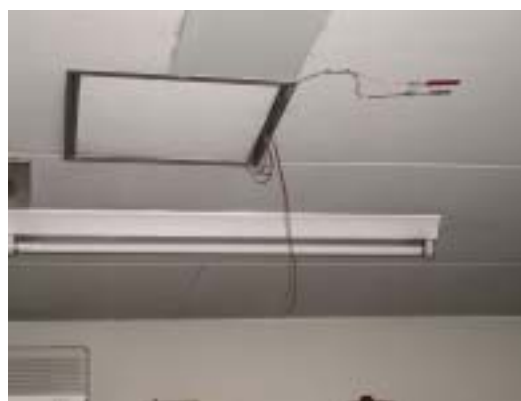
熱流計・熱電対設置状況（室内）
