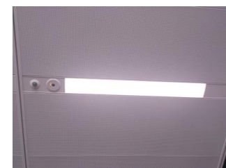
アンビエントLED照明
