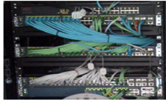
ラック内のケーブルを束ねて 通気性を確保
