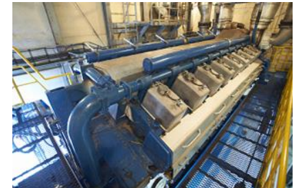
ガスエンジンCGS
