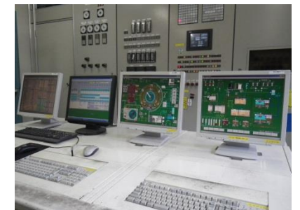
遠隔監視システム
