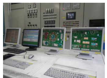
エネルギー監視システム
