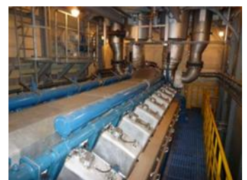
ガスエンジンCGS
