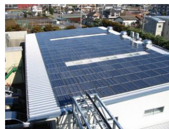
太陽光発電システム
