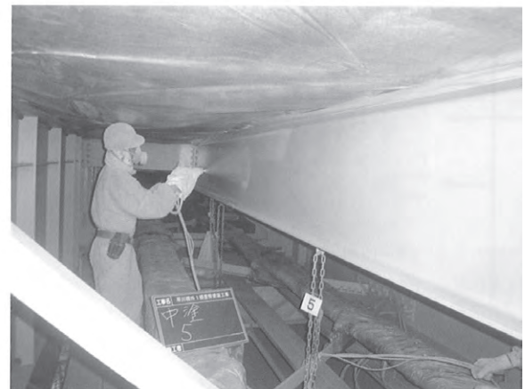
付図 4-2 静電エアラップエアレス塗装法を用いた施工状況
