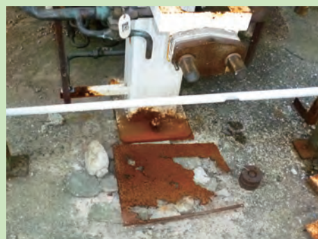
ガス排出口下の基礎コンクリートの劣化
