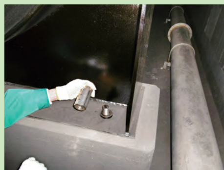
固定部ナットの緩み
