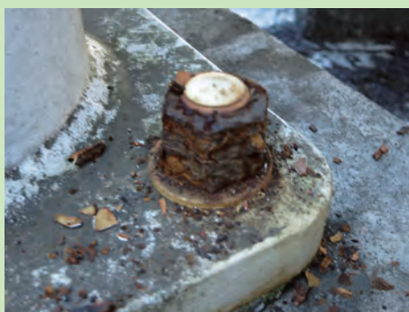
固定部ナットの腐食
