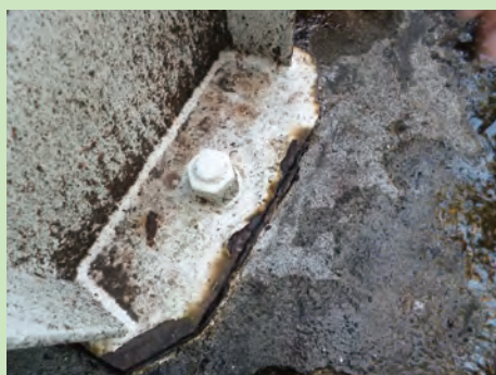
固定部ベースプレートの腐食・減肉
