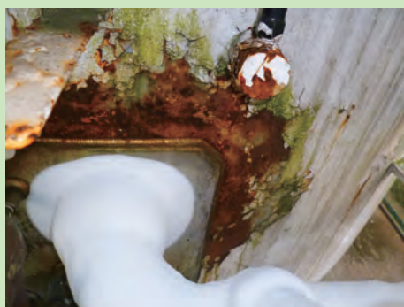
貯槽本体の錆
