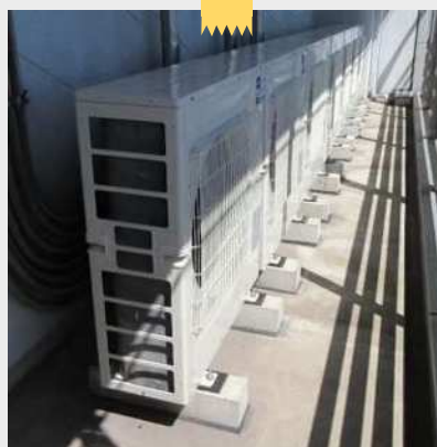
【室外機（各階ベランダ）】
