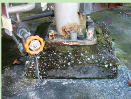
基礎立ち上り部コンクリートの劣化
