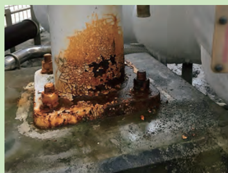
支持部・固定部の腐食・劣化
