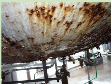
貯槽底部の腐食
