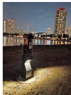
【都有施設への先行導入】 お台場海浜公園 庭園灯
