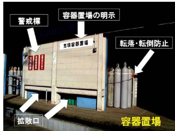
高圧ガスの貯蔵例
