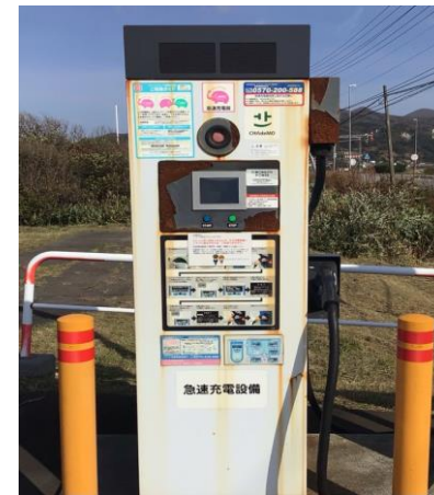
老朽化した充電設備
