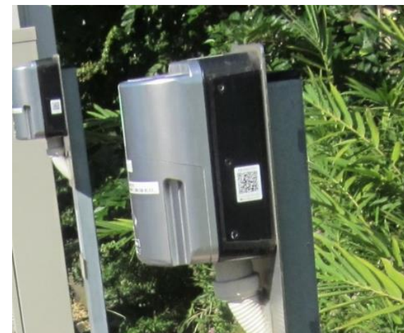
普通充電設備 (石神井公園)
