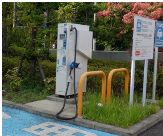
急速充電設備 (立川合同庁舎)
