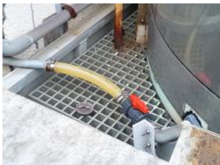
ゴム製の配管
