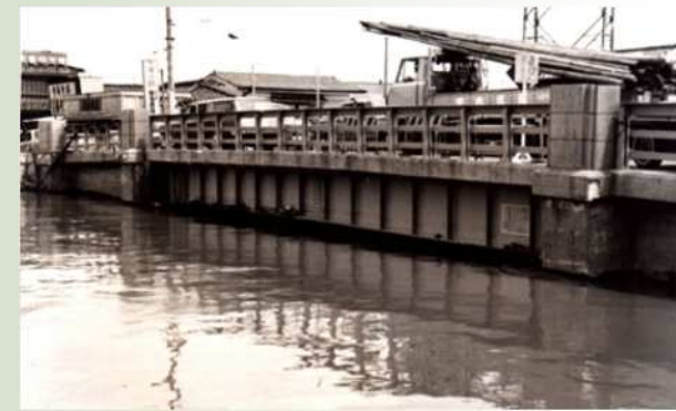
写真1：河川の両岸とともに橋が沈下し、船舶の航行が困難になった (昭和35年頃 綾瀬川)
