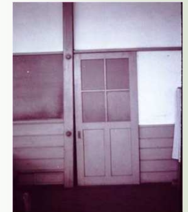
写真3：閉まらなくなった小学校の扉 (昭和38年 北区)
