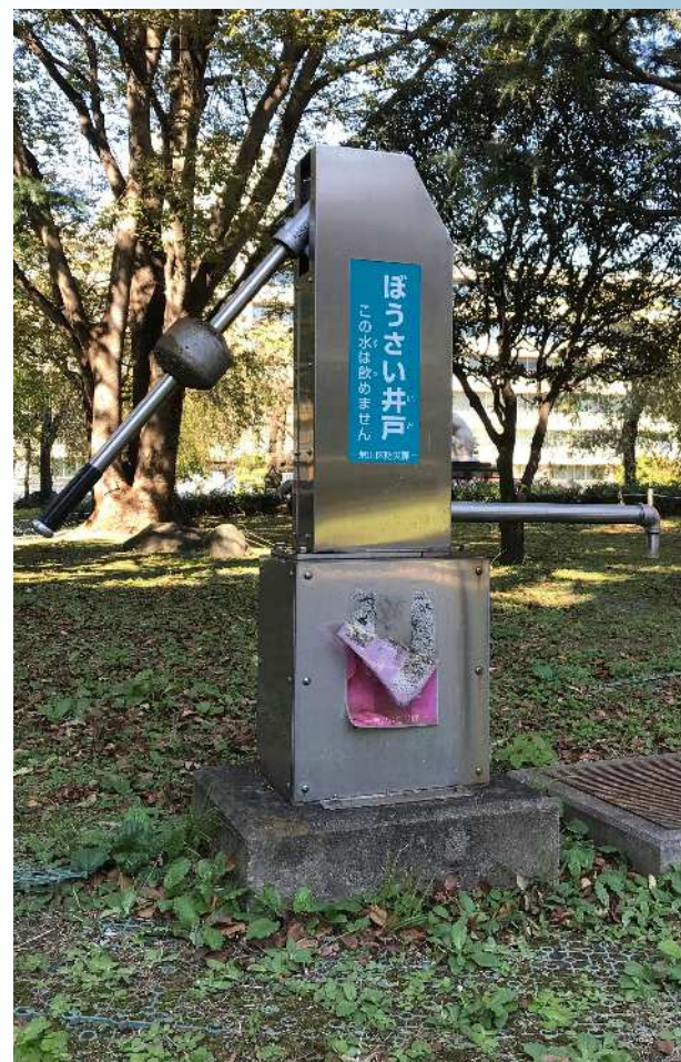
荒川公園内に設置の防災井戸 (手押しポンプ)
