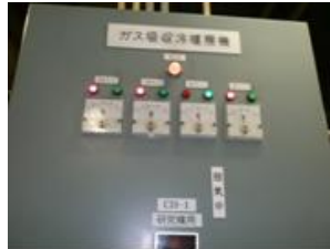
計器場所例(個別の制御盤)
