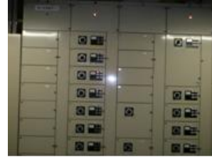
計器場所例(集中配電盤)
