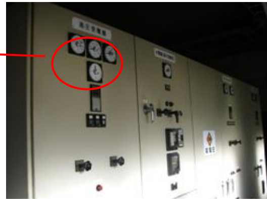
高圧受電盤(キュービクル)のイメージ
