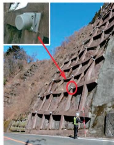
グラウンドアンカー
