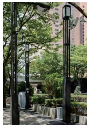
西新宿にある5G基地局搭載の スマートポール
