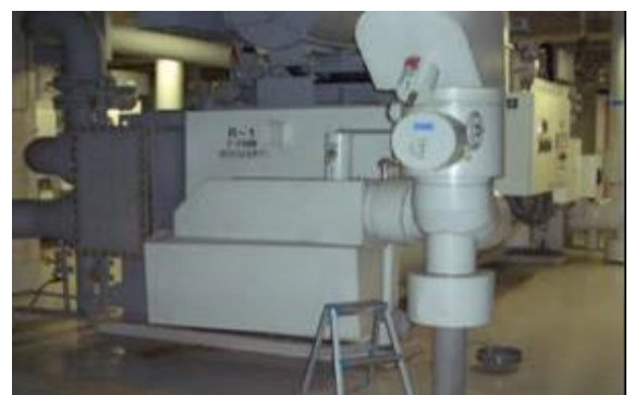
ターボ冷凍機
