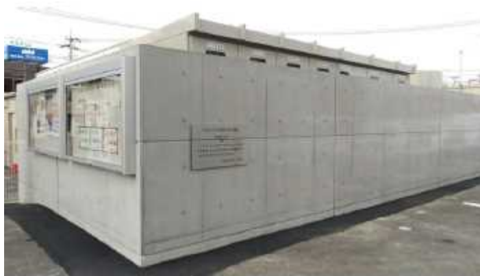
電気設備周囲への塀設置の例
